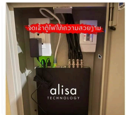
ตู้ควบคุม Control cabinet
