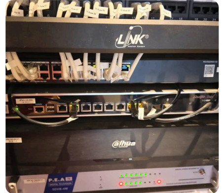
จัดสายและติดป้ายทุกพอร์ต, Kiridara Every port labelled, Kiridara
