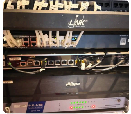
ຈັດສາຍ ແລະ ຕິດປ້າຍທຸກພອດ, Kiridara Every port labelled, Kiridara
