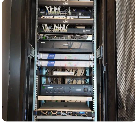
ຕູ້ແຮັກຫຼັກ ໂຮງແຮມ Kiridara ຫຼວງພະບາງ Main rack, Hotel Kiridara Luang Prabang
